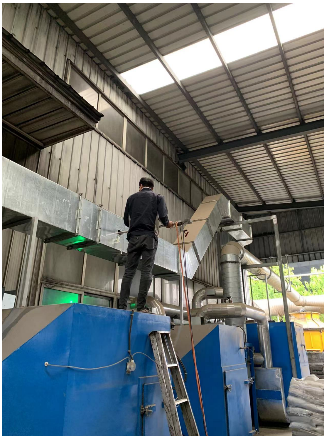
浸涂废气（进口）监测取样
