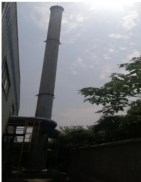
图 4.1-5 工艺废气排气筒
